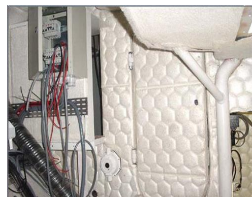
Aislamiento térmico en sala de máquinas
